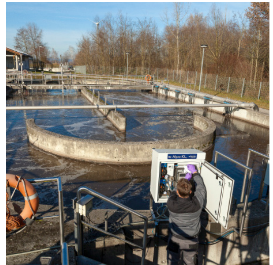
Typische Installation des Alyza IQ PO 4 neben der biologischen Reinigung
